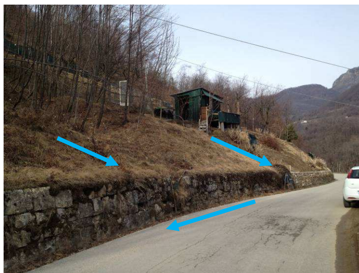
Foto 3 - Strada a monte della frana priva di capitoie sul manto stradale
