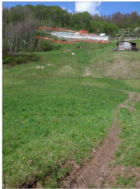
Foto 1 - Vista dal torrente della zona soggetta a frana e dei lavori di ripristino del tratto stradale di accesso al nucleo abitato visibile sulla destra
