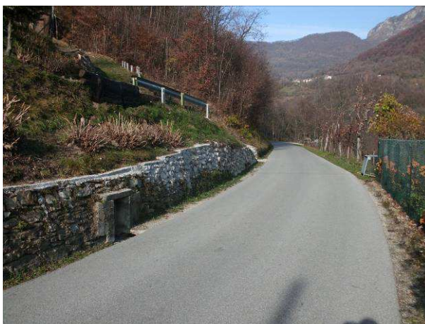
Foto 5 – Pozzetti esistenti di scarico sulla strada a monte, in coincidenza del nucleo abitato
