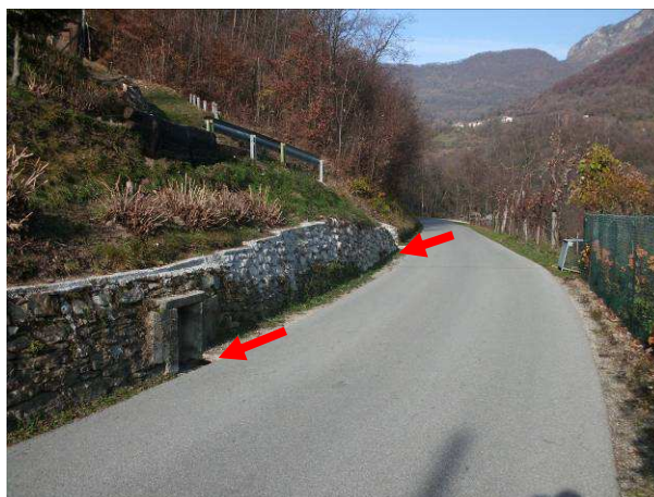
Foto 7 – Pozzetti esistenti di scarico sulla strada a monte da ripristinare
