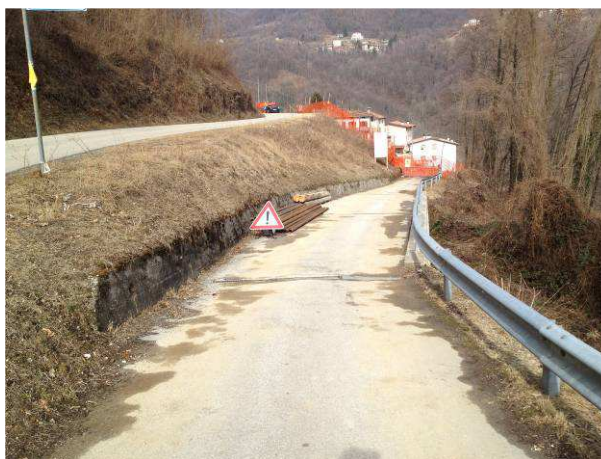
Foto 6 – Pozzetti esistenti di scarico sulla strada a monte, in coincidenza del nucleo abitato
